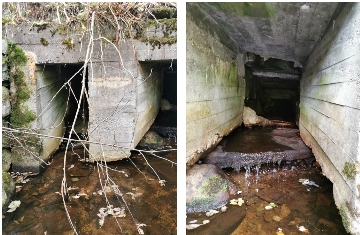
Figur 16. Kulvert under Søndeledveien vurderes som vandringshinder for fisk. Foto: Yvonne Rognan.
