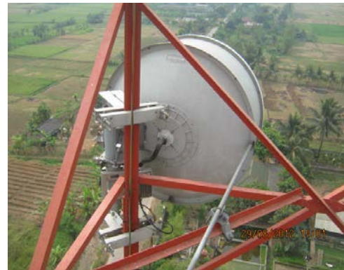
Gambar 4.20 Kondisi Antena pada setelah dilakukan troubleshooting (gambar diambil esok harinya )
