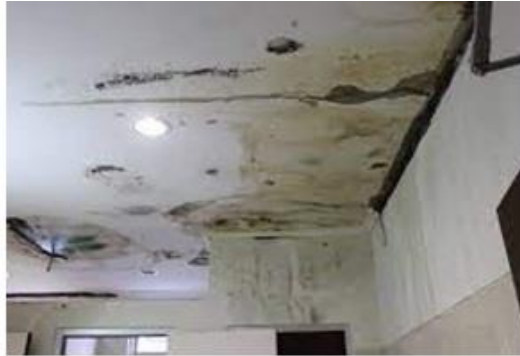
Gambar 5. Dampak rembesan air pada atap dak Sumber: ( https://manajemenproyekindonesia.com/ )
