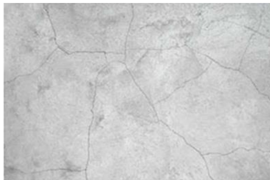
Gambar 4. Retak Rambut pada atap dak beton Sumber: ( https://www.arsitur.com/2019/ )
