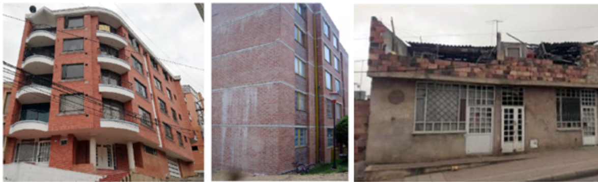
Figura 2. Sistemas estructurales. Pórticos (izquierda), muros de carga en mampostería confinada (medio) y muros de carga en mampostería no reforzada (derecha).
