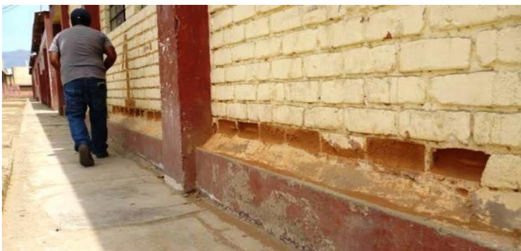
Figura 01: Muros deteriorados talleres, Colegio Politécnico Fuente: Chimbote en línea
