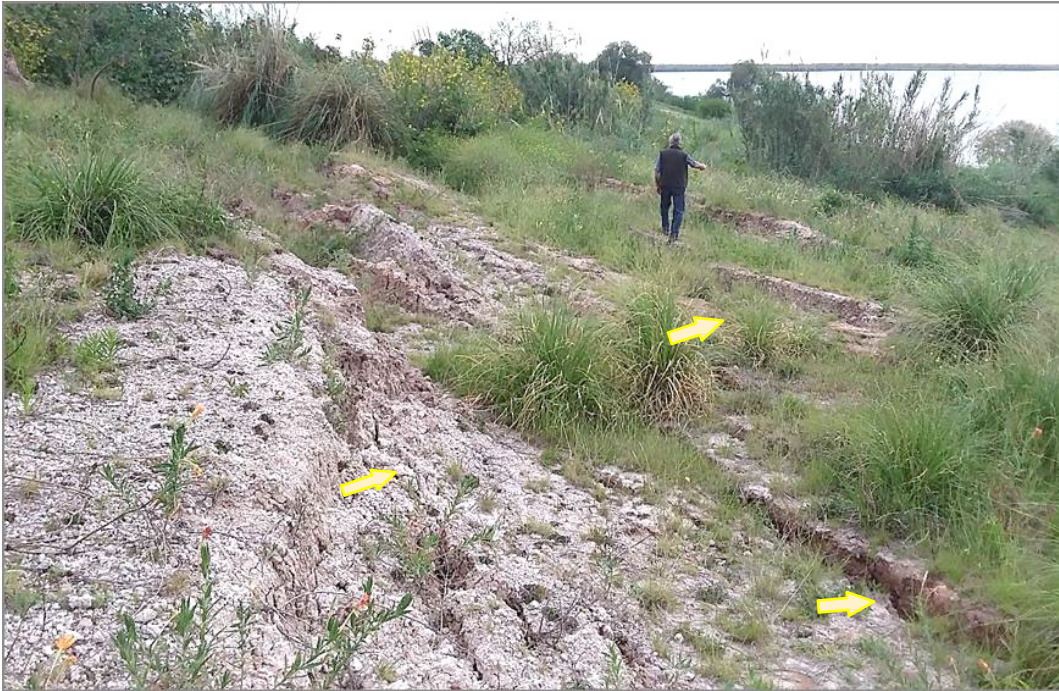
Figura 7. Sector con grietas de expansión y descenso de bloques. Lugar donde se excavó la calicata ubicada en el centro del macizo movilizado, al pie de la barranca.
