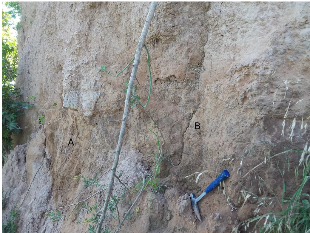
Figura 17. En (A) se observa el sector de descarga del acuífero confinado en la barranca. En (B) se observa una grieta de tracción que, partiendo de la parte superior de la barranca, se profundiza en el macizo rocoso llegando al acuífero.
