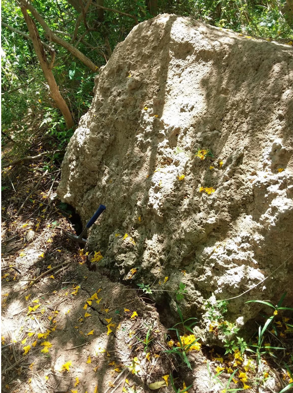
Figura 16. Bloque de calcrete ubicado al pie de la barranca y separado por grietas del suelo que lo rodea.
