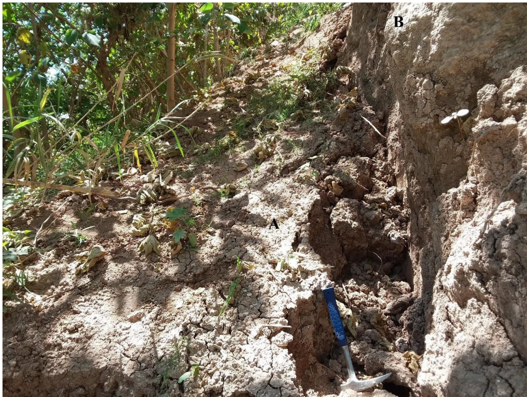
Figura 15. Fracturas de extensión abiertas que separan el talud (A) de la barranca (B), indicio inequívoco de que la extensión se extiende hasta la barranca.
