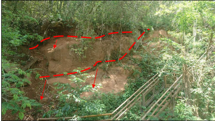
Figura A1.12. Arriba: Vista general del afloramiento en relación con la pasarela. Centro: Detalle del macizo rocoso. En el recuadro rojo se observa el arreglo de una de las bases de fundación que fue descalzada tras el desprendimiento del bloque sobre el cual apoyaba. Se puede notar que la misma presenta cierta excentricidad. Abajo: Vista en detalle de la zona afectada por el último evento de deslizamiento. Las líneas punteadas indican los planos de ruptura y las flechas la dirección del movimiento.
