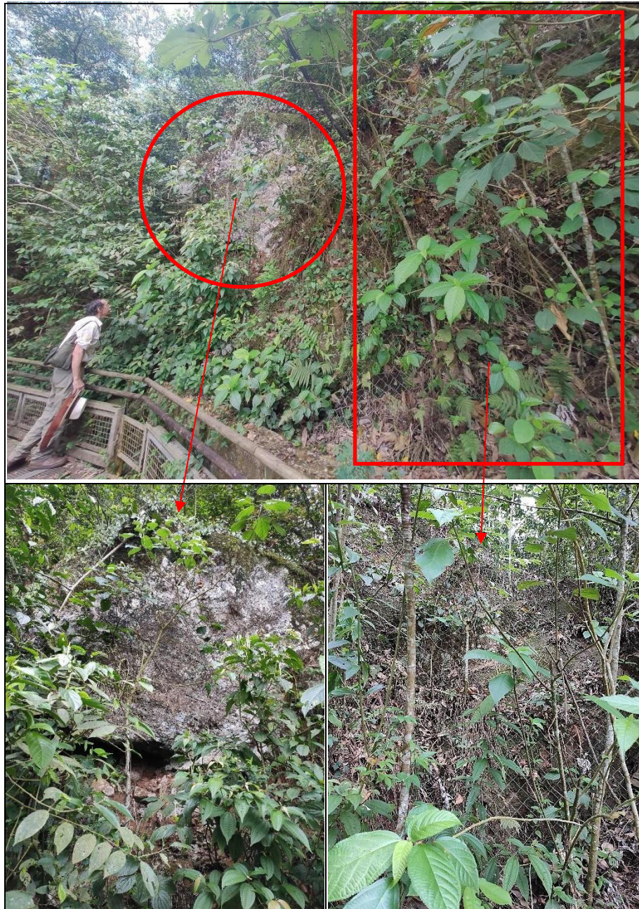
Figura A1.4: Arriba vista general del afloramiento, donde se distingue la situación del bloque inestable en relación con la pasarela y el mallado metálico colocado por la Concesionaria del Circuito. Abajo: Vista en detalle del bloque inestable (izquierda) y de la malla metálica (derecha).
