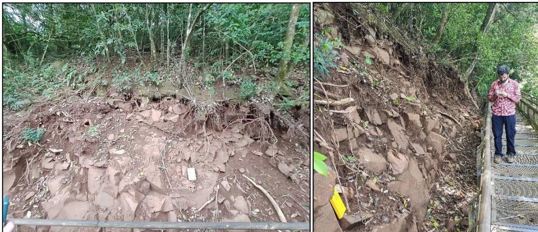
Figura A1.8. Izquierda: vista general del deslizamiento. Derecha: Vista en detalle del plano de rotura en relación con la pasarela y las labores de mantenimiento. Nótese la superficie de rotura irregular.
