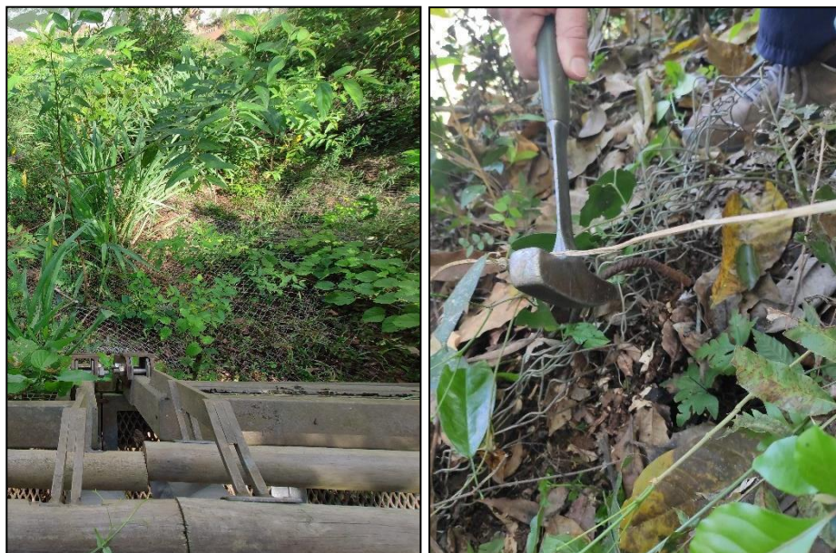
Figura A1.11: Izquierda: Malla metálica colocada por la Concesionaria del Circuito para mitigar el proceso de deslizamiento por colapso de rocas y caída de bloques. Derecha: Anclaje para el sostenimiento de la malla.
