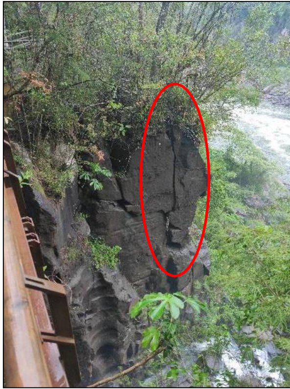
Figura A1.17. Bloque en posición de vuelco. Nótese la discontinuidad subvertical abierta que limita el bloque y el plano de deslizamiento que forma la base.
