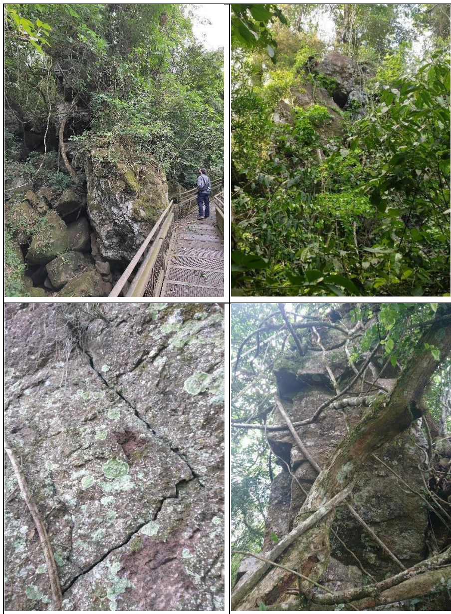
Figura A1.1. Arriba: Vista generales de los afloramientos. Abajo: Detalle del macizo rocoso.
