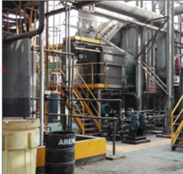
Figura 7.9. Planta de Generación de Vapor.
