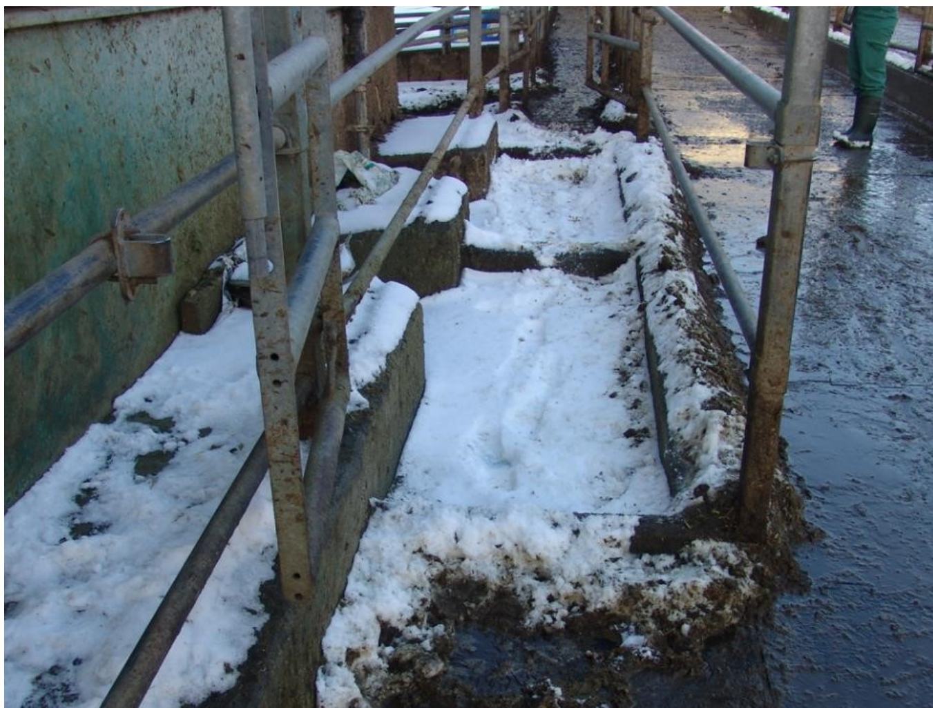
Abbildung 44: Fest installiertes Durchlaufbecken zur Klauendesinfektion der Milchkühe ohne Witterungsschutz
