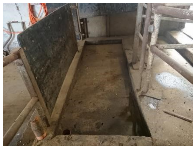
Abbildung 28: Neu installiertes Klauenbad des Betriebes 10 bei der zweiten Systemanalyse
