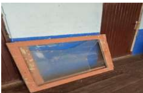
Gambar 2. Jendela kelas yang pecah
