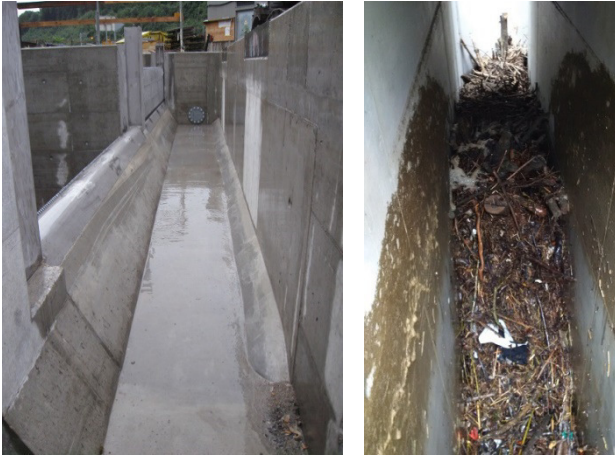
Abb. 17: Links Sammelrinne nach Fertigstellung am WKW Esslingen mit Möglichkeit zur Installation einer Spülpumpe (Rohrleitung mit Blindflansch am hinten liegenden Ende der Spülrinne). Rechts verstopfte Sammelrinne mit Ästen und Müll am WKW Künzelsau.
