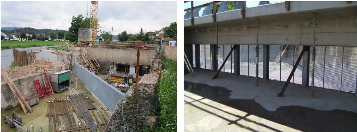
Abb. 8: Schrägrechen am WKW Ottenau mit 44°-Anströmwinkel und 18 mm Stababstand während der Bauzeit in Blickrichtung Unterwasser (links) und in Blickrichtung Oberwasser (rechts) (Quelle: EnBW, 2012).
