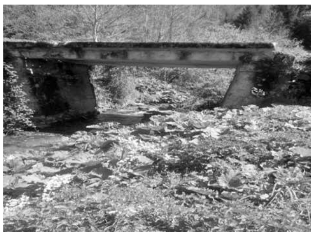
Slika 6. Oštećenje mosta na šumskoj cesti Fig. 6 Damage to a forest road bridge
