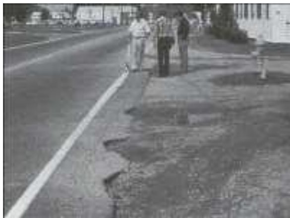
Gambar 2.22 Retak Tepi Dengan Keparahan Tinggi
