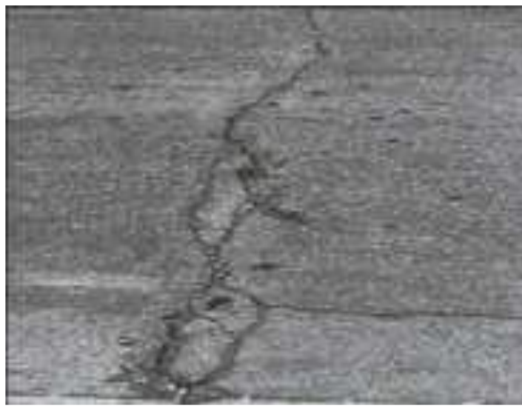
Gambar 2.24 Retak Refleksi Sambungan Keparahan Sedang
