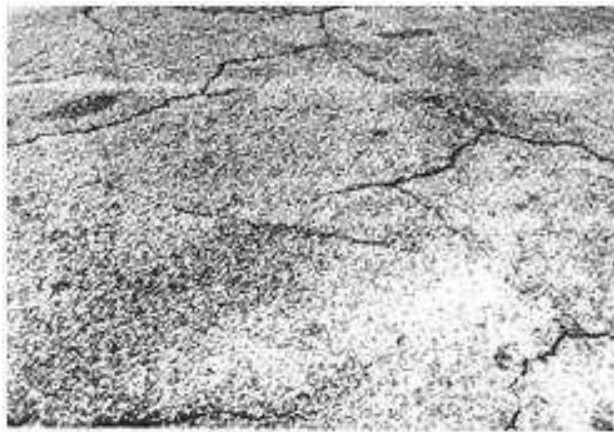
Gambar 2.10 Retak Blok Keparahan Tinggi (Sumber : pedoman PUPR)
