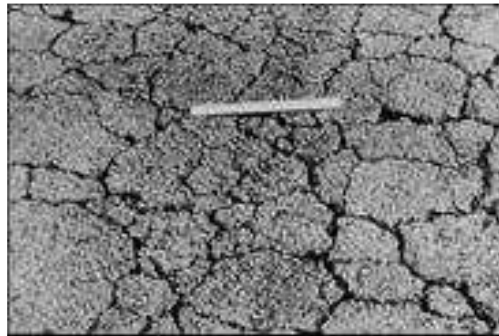
Gambar 2.4 Retak Kulit Buaya Tinggi (Sumber : pedoman PUPR)
