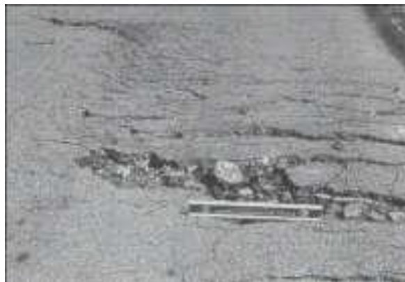
Gambar 2.44 Retak Selip Keparahan Tinggi
