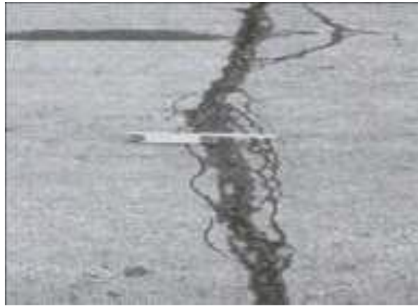
Gambar 2.25 Retak Refleksi Sambungan Keparahan Tinggi
