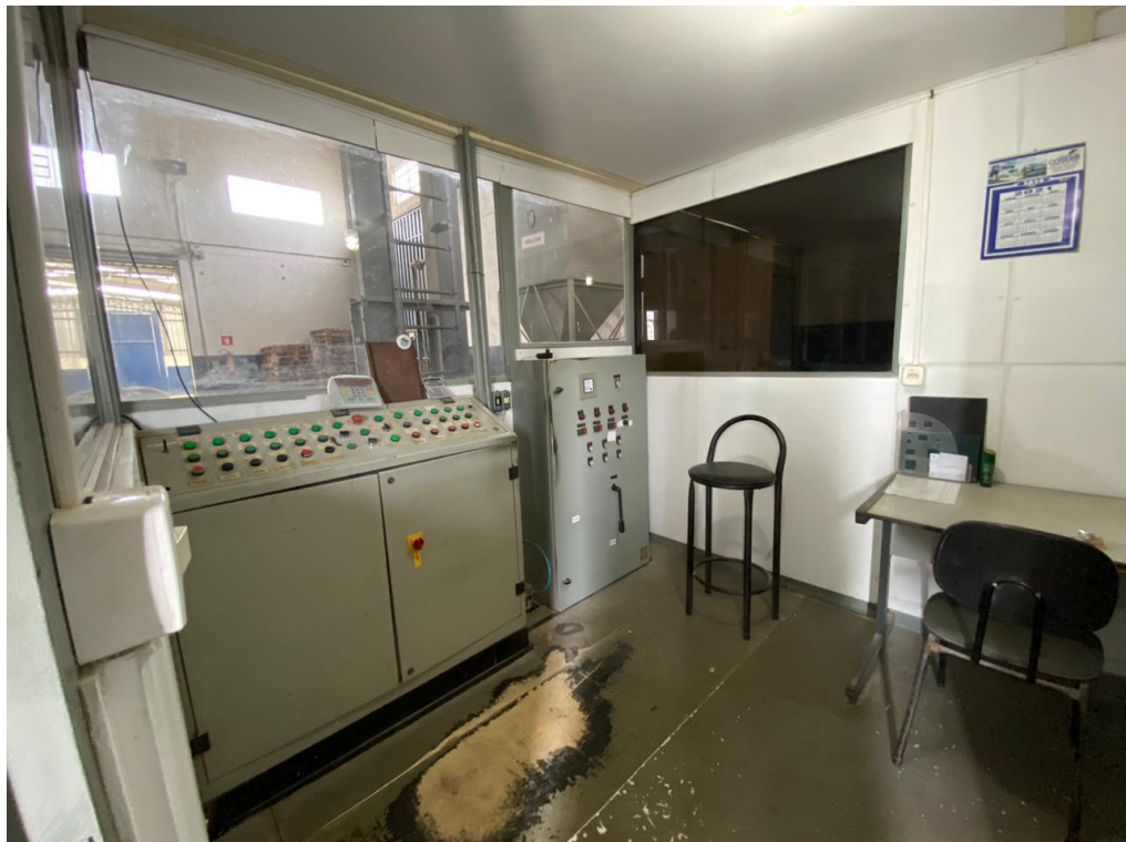
Figura 5 – Painel de controle Fonte: O próprio autor, 2021
