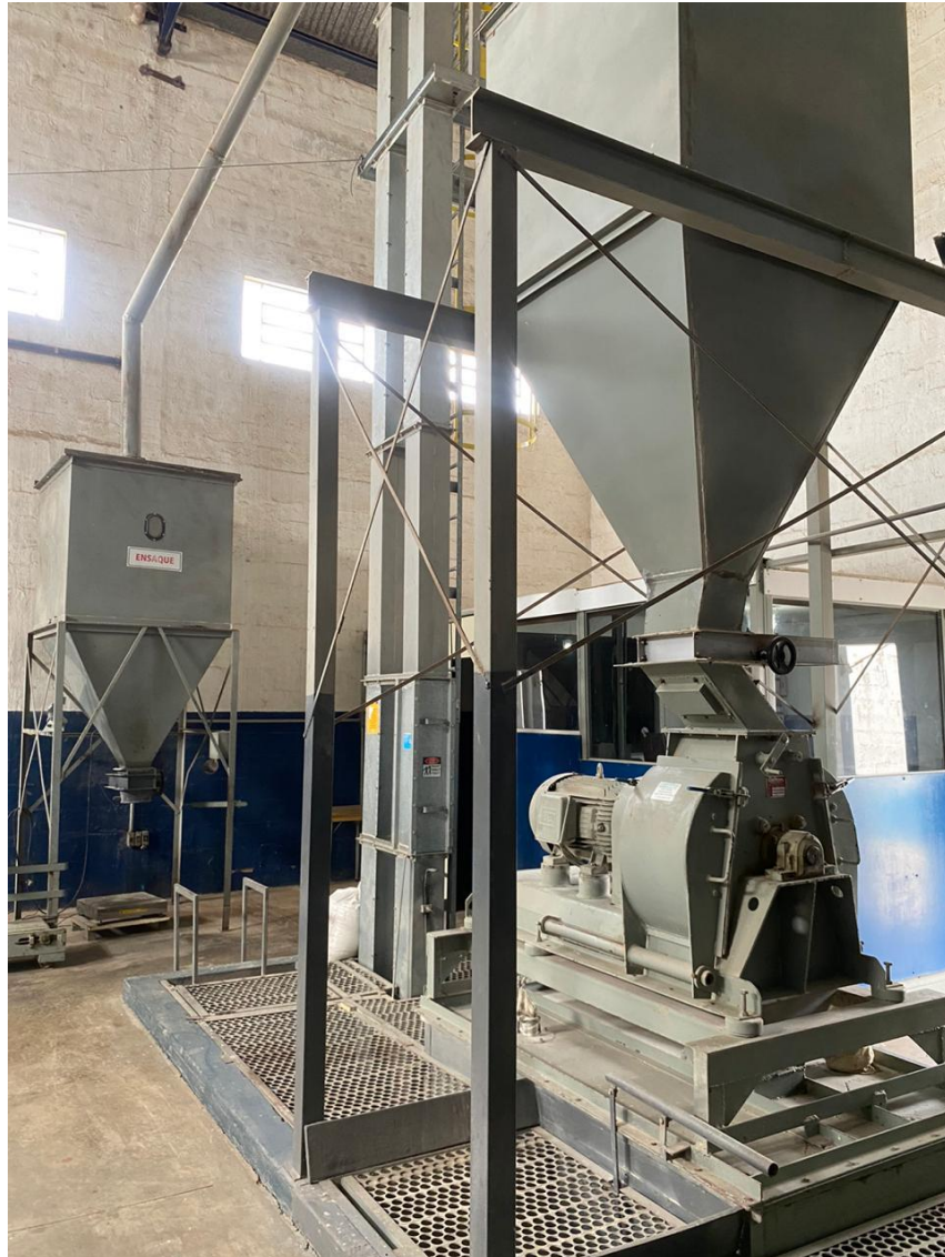
Figura 3 – Moinho, misturador, caixa de espera do setor de fabricação. Fonte: O próprio autor, 2021.
