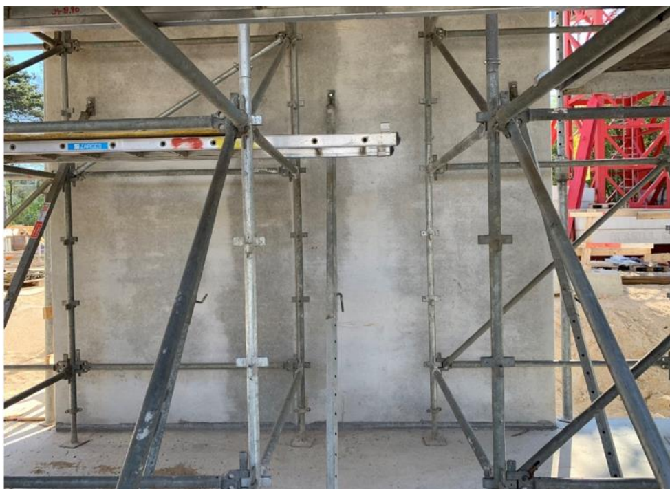
FIGUR 31. Overflade på betonelementer til etape 2.2. Kilde: Notat af forhenværende bygherrerådgiver.
