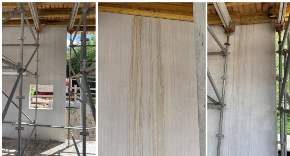
FIGUR 34. Rustløbere på ny beton.
