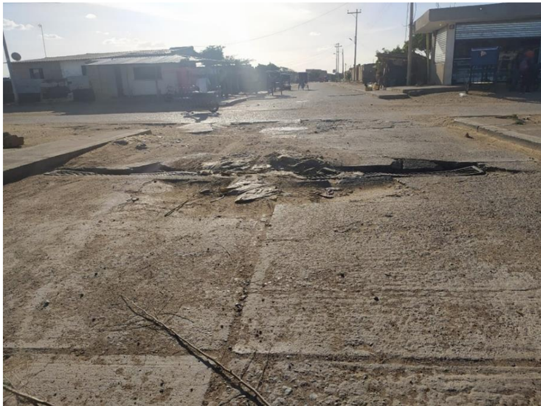
Fotografía 27. Vía en mal estado casco urbano de Uribia. Fuente: Autoría Propia.
