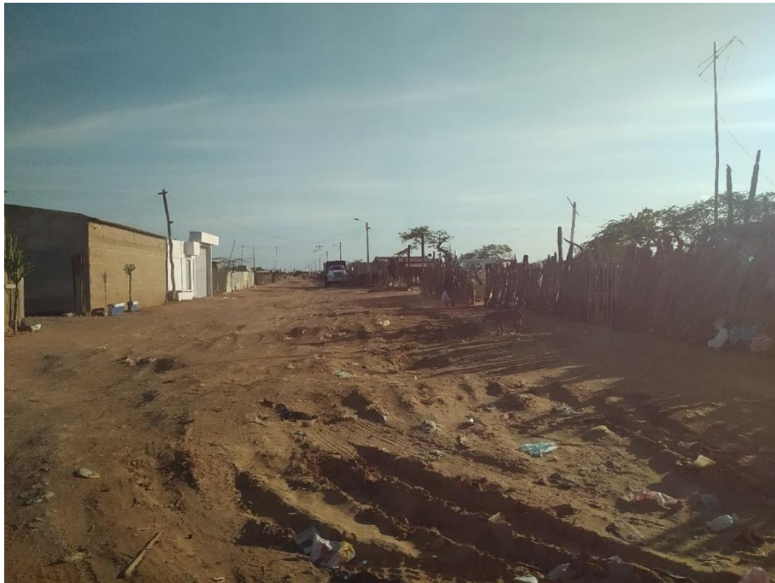
Fotografía 29. Vía en mal estado zona periférica de Uribí Fuente: Autoría Propia.
