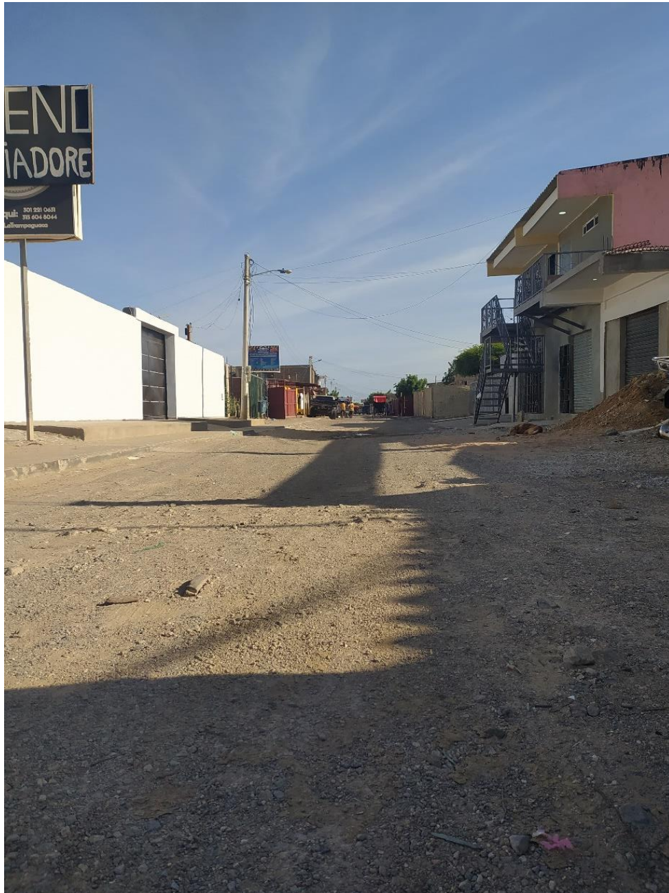
Fotografía 28. Vía en mal estado casco urbano de Uribia. Fuente: Autoría Propia.
