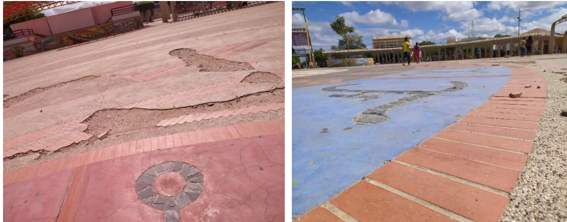
Fotografía 52. Deterioro del suelo en la Plaza Colombia. Fuente: Autoría propia
