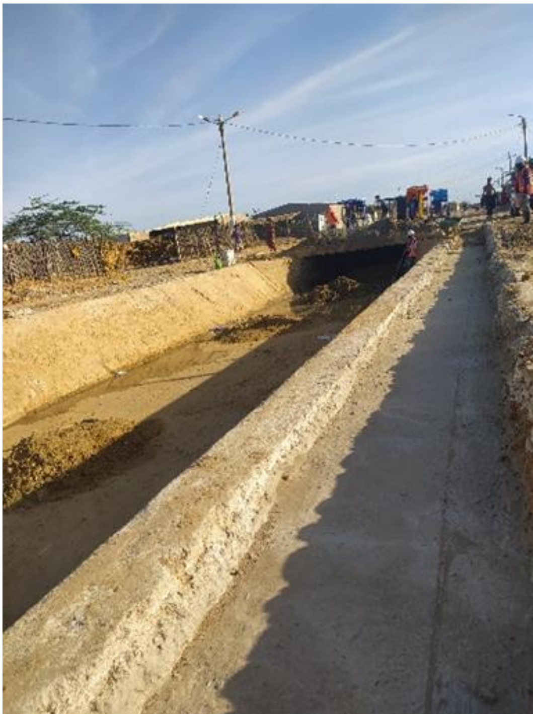
Fotografía 104. Canal Subterráneo, Barrio Fonseca Siosi. Fuente: Autoría propia
