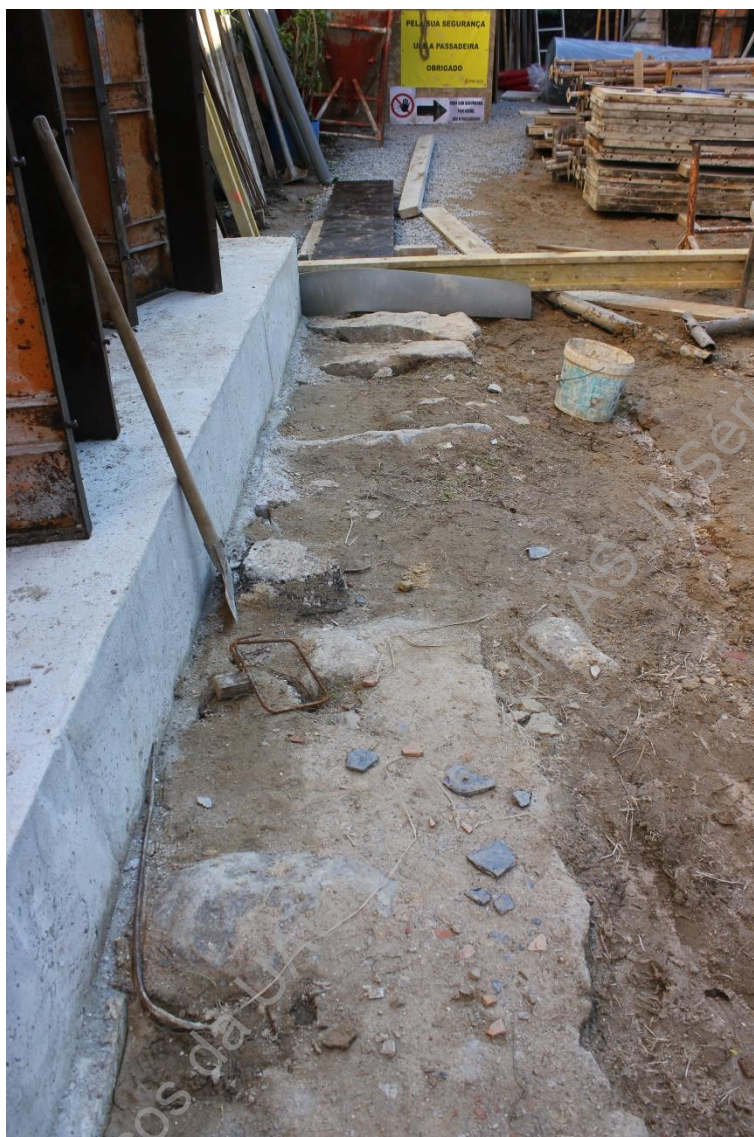
Foto 4 (IMG_6829) – Identificação da canalização UE002, 003, 004.
