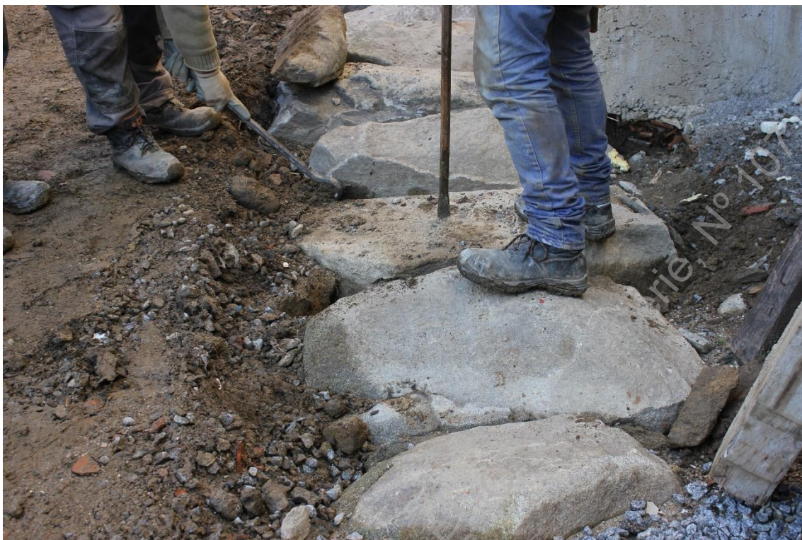
Foto 7 (IMG_7054) – Acompanhamento do levantamento de câpea da canalização UE002, 003, 004, para registo do interior.
