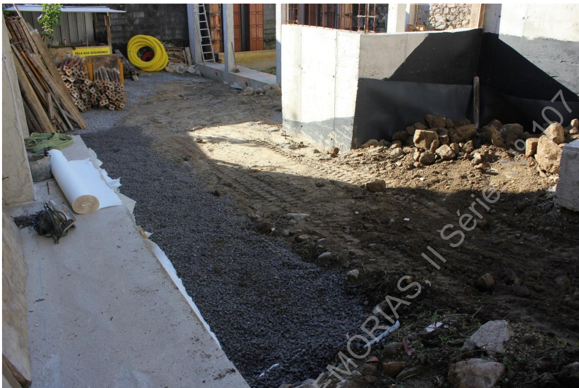
Foto 13 (IMG_9808) – Proteção da canalização UE002, 003, 004 com aplicação de manta geotêxtil e gravilha.
