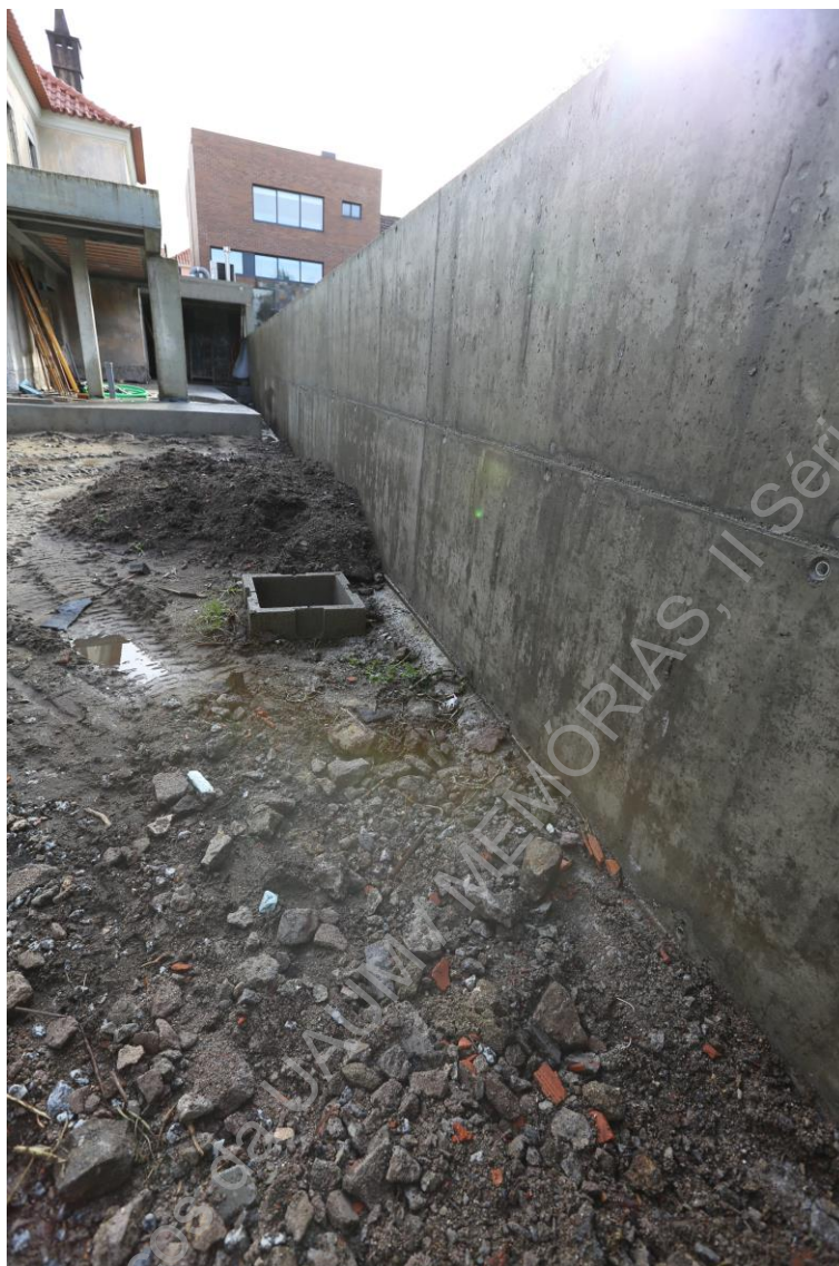
Foto 9 (IMG_1902) – Acompanhamento dos trabalhos de substituição do sistema de drenagem de resíduos hídricos.
