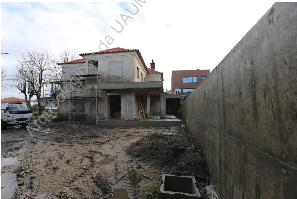
Foto 6 (IMG_1874) – Muro de contenção de terras e ampliação da habitação a oeste.
