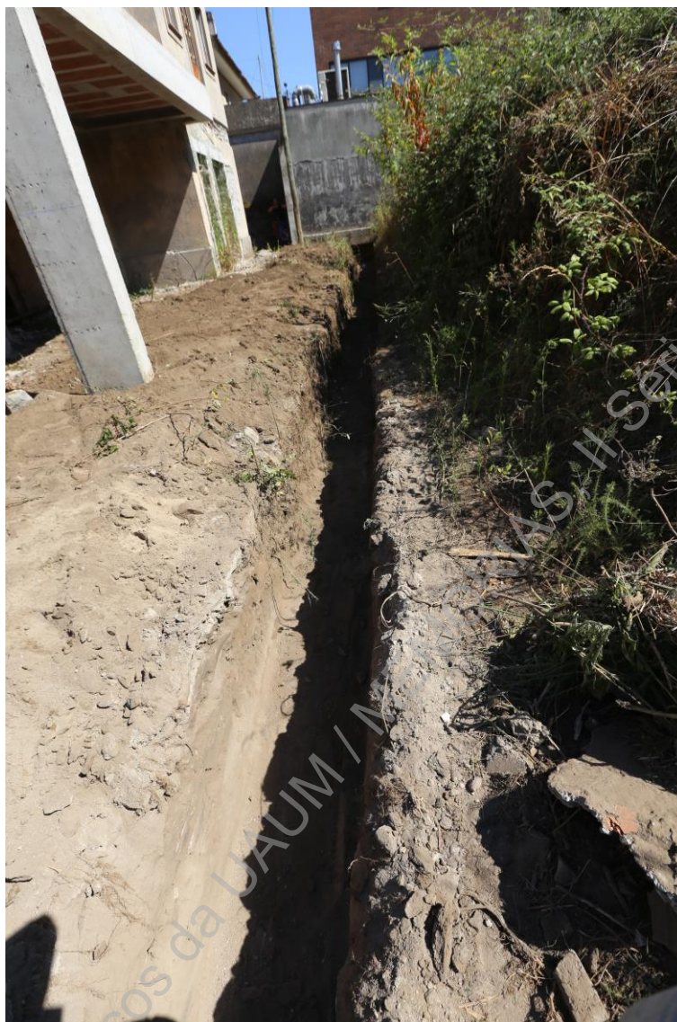
Foto 4 (IMG_9718) – Perspetiva da vala para implantação do muro de contenção das terras.
