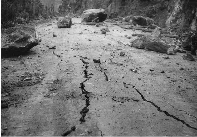
Figura 3. Agrietamientos en el sector Las Adjuntas. Fuente: Deno y Bushman, 1950
