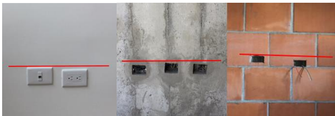
Figura 38. Falta de alineación en salidas eléctricas.
