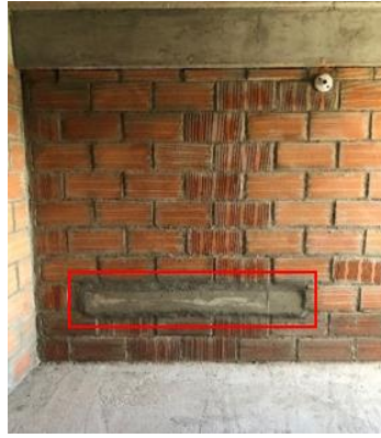
Figura 54. Elemento de estructura incrustado en muro del inmueble.
