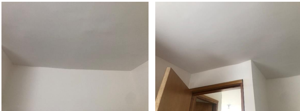
Figura 51. Falta de planeidad en cielo (se observan ondulaciones).
