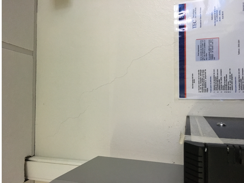
(h) Evidencia de grietas en Muro M2-b Fuente: Propia.
