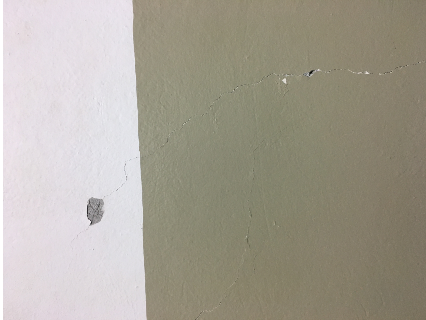
(f) Evidencia de grietas en Muro M1-b Fuente: Propia.
