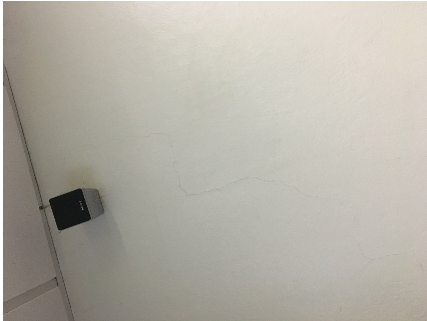
(i) Evidencia de grietas en Muro M3-a Fuente: Propia.
