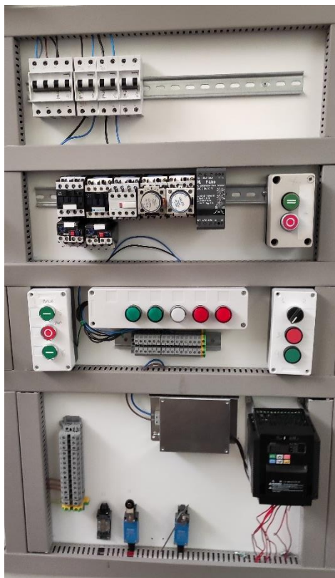
Figura 7. Panel de prácticas del taller de automatismos eléctricos del IES Trinidad Arroyo de Palencia. Fuente: elaboración propia
