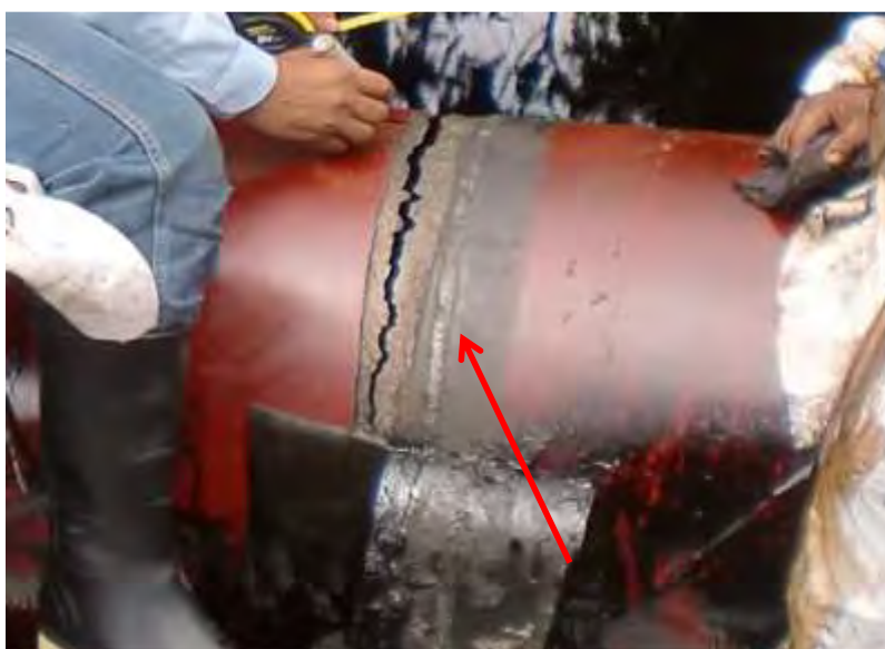
Foto N° 2 del 10 de julio de 2014 (segunda visita de supervisión). Se puede apreciar la falla (rajadura) del Oleoducto, punto donde se produjo el derrame, altura del km. 42 del Oleoducto Norperuano.
