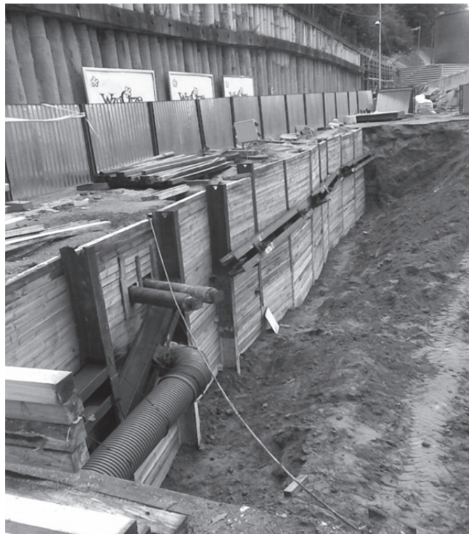
Zdjęcie 4.3.1. Dokumentacja fotograficzna wykonania etapu 2 fazy głębień wykopu z obudowa berlińska Źródło: Apsys Polska S.A. (inwestycja CH Wzgórze w Gdyni).
