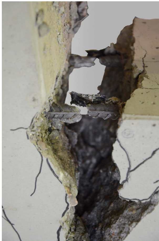
Pręty zbrojenia głównego zerwane podczas badania Main reinforcement bars were ruptured during test
