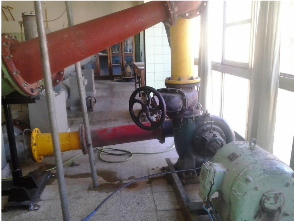
Figura 39. Imagen de la bomba de alimentación en el banco de ensayos.
