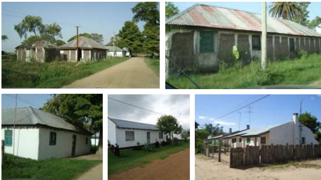
Figura 74. Viviendas de “fajina” en Arrozal 33; Tipologías de vivienda en Arrozal 33, San Fernando y CIPA Olimar.
