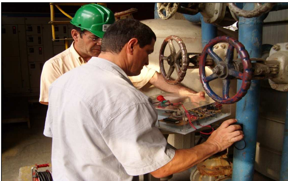
Figura Planta de agua Tubo N°3 Acero (equipo Prot otipo)
