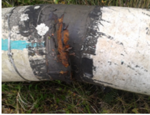
Figura 2.5: Ejemplo de abolladura. Fuente CIC.
