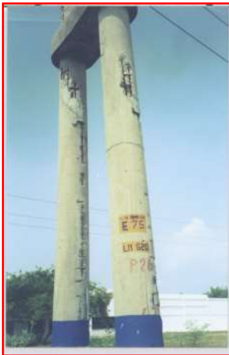
Figura No.14 Corrosión Interna Poste en concreto
