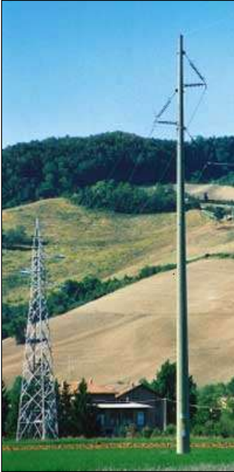
Figura No.18. Poste para transmisión de energía
