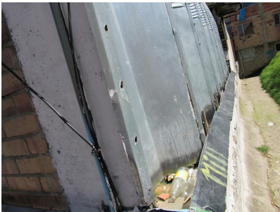
Foto 22. Fuente: Propia. Pliegue de archidrón con basura acumulada, en algunas viviendas, la acumulación de basuras ha carcomido el metal, provocando filtraciones de agua al interior de las casas, afectando la salud de los niños.
