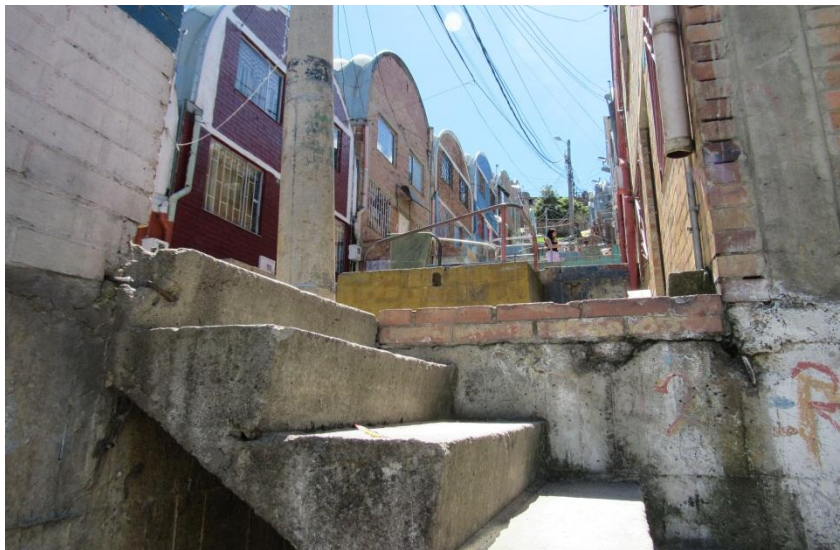
Foto 26. Fuente: Propia. La humedad producida por la mala estructuración de las tuberías y el alcantarillado en el proceso de construcción de la urbanización, es otro de los puntos centrales en las discusiones del barrio.
