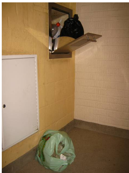
Fotografía 4-1. Ducto de basura
