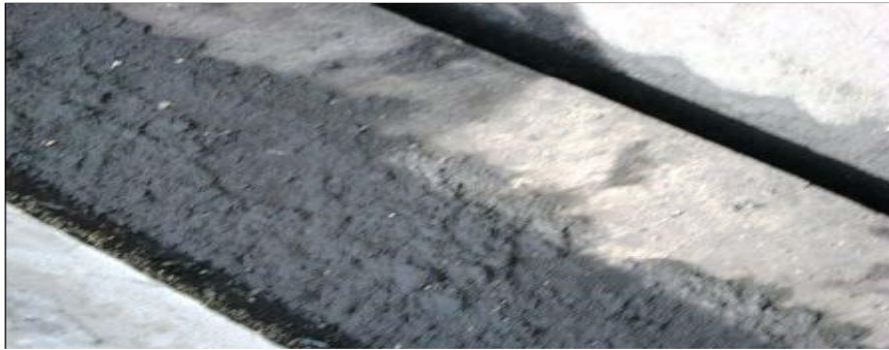
Figura N° 2.3.- Láminas de cemento con lodo adherido a las paredes
