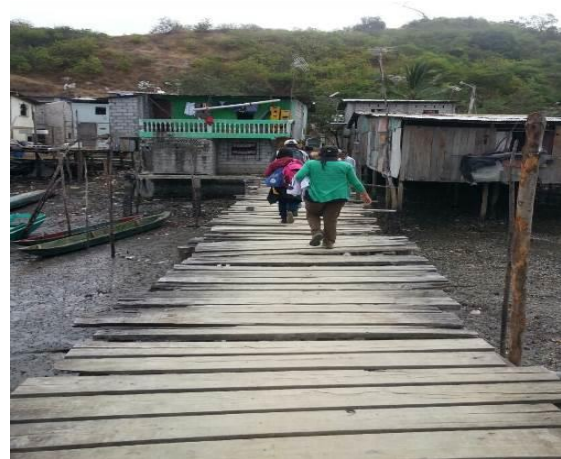
Foto 3.- Estado del muelle
