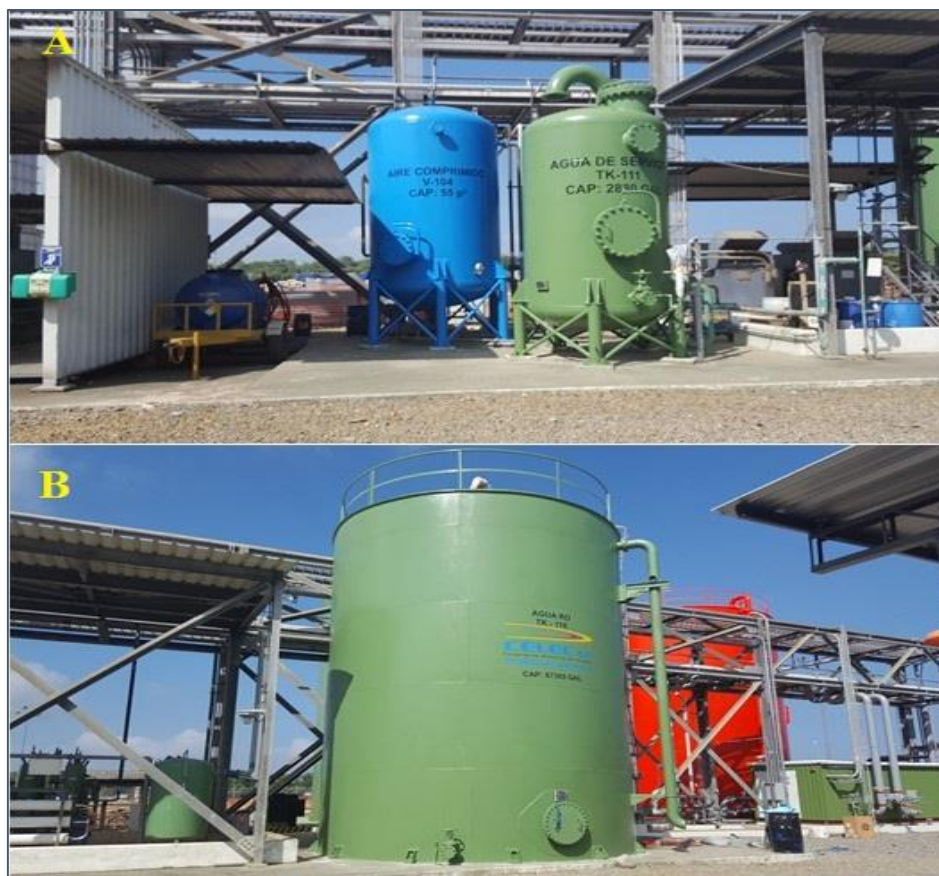
Figura 7. A: Depósito TK-111; B: Depósito TK-116 Fuente: (Efficacitas Consultora Cía. Ltda., 2015)
