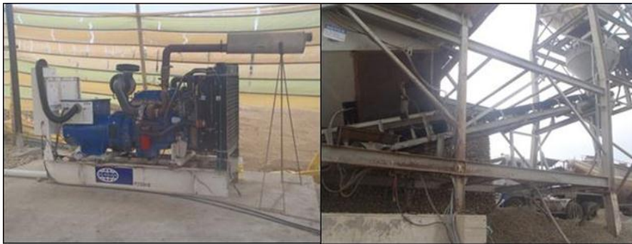
Fuente: Planta de Hormigón San Carlos Elaboración por: Ing. Ind. Duarte Nivelá Ángela Larizza
