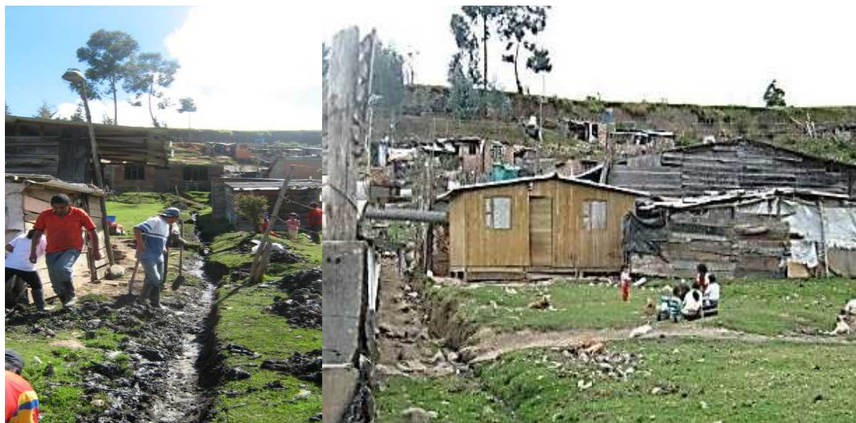
Fotografía 7. a. Limpieza de zanjas para evacuación de aguas servidas. b. Pejendino Reyes (formas de habitar).
