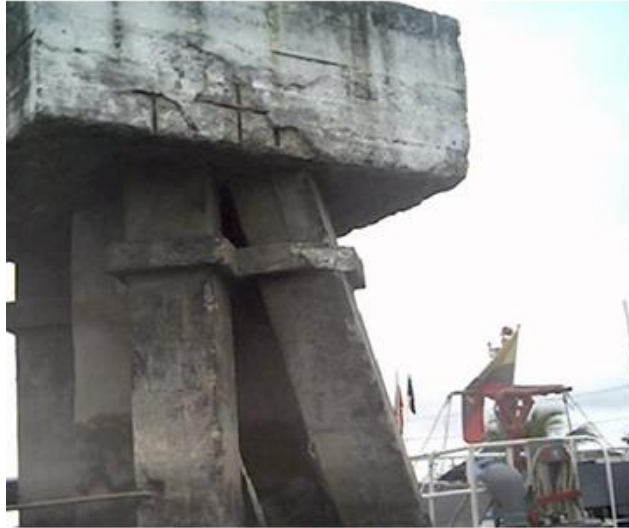
Foto 3: Plataforma del dolphin del muelle No 2. Presenta desprendimiento del hormigón y algunos de los pilotes se encuentran fisurados. Fuente: (SÍSMICA Ingenieros Consultores, 2004)
