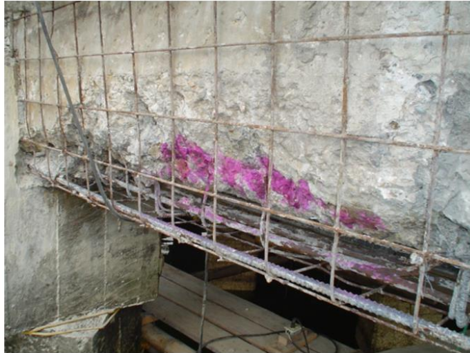
Foto 13: Prueba de carbonatación con fenolftaleína en viga.
