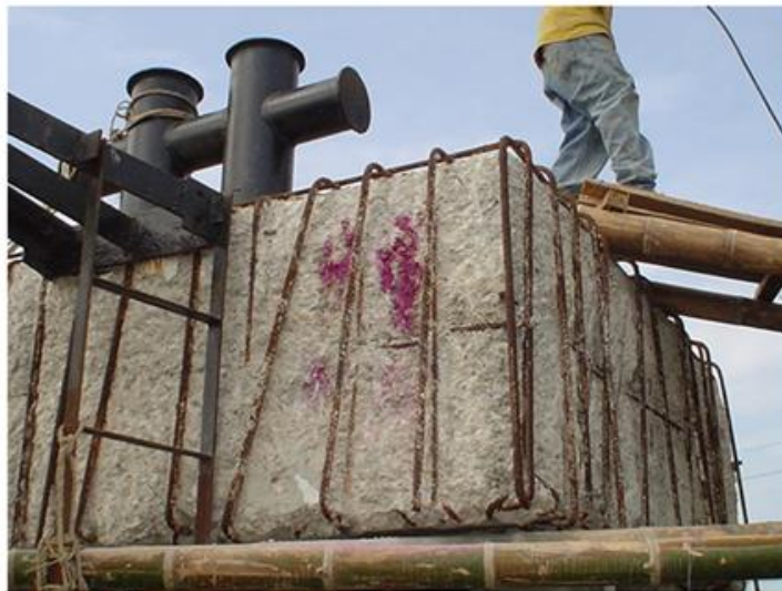
Foto 14: Prueba de carbonatación con fenolftaleína en losa de dolphin.
