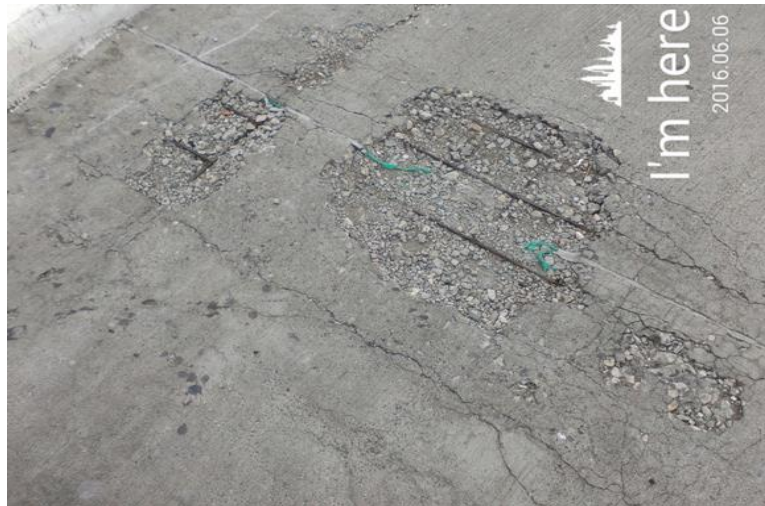
Foto 24: Estado actual de losa muelle No 2 Presenta desgaste con acero expuesto
