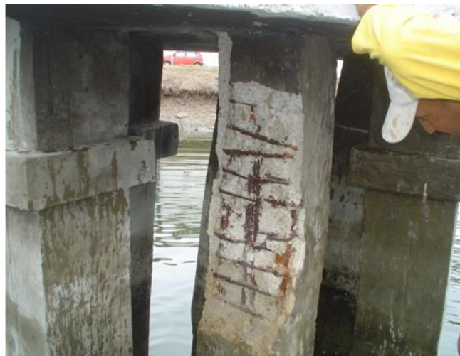
Foto 4: Pilote del dolphin del muelle 2 El acero de los estribos y recubrimiento ya no existen. Fuente: (SÍSMICA Ingenieros Consultores, 2004)
