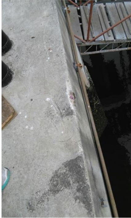
Foto 19: Reacción leve en prueba de Carbonatación con fenolftaleína en losa.
