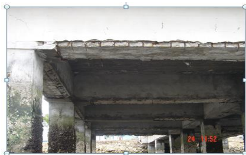
Foto 2: Viga de muelle No 1 con acero expuesto y desprendimiento del hormigón
