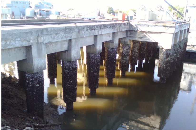
Foto 25: Estado actual de Pilotes muelle No 2
