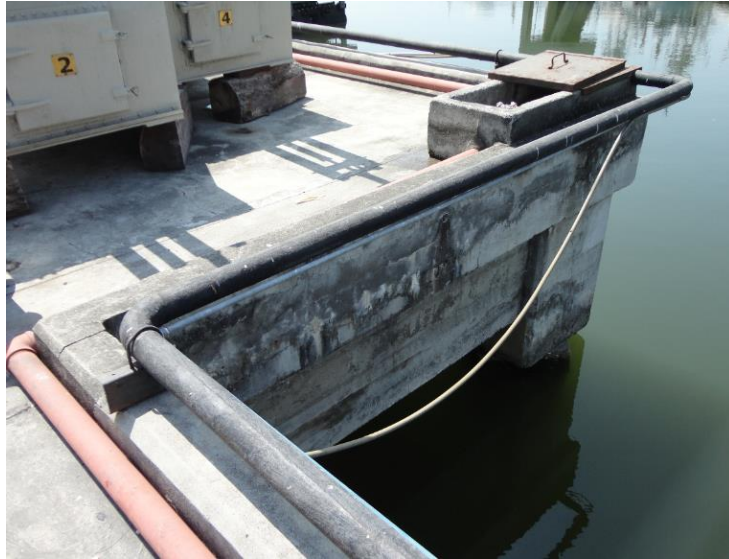
Foto 23: Estado actual de vigas muelle No 2 BASUIL
