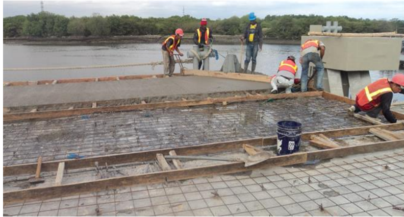
Foto 15: Armado y fundición de sobre losa de 10 cm con conectores y malla f'c=35 Mpa.
