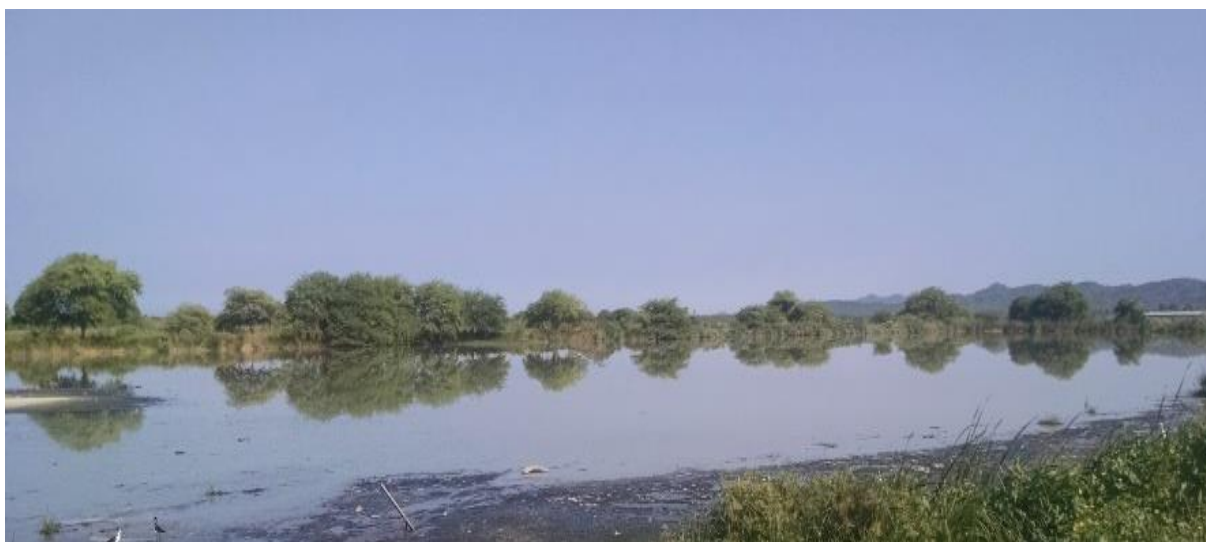
Vista general de laguna facultativa No 1, donde se aprecia la cantidad de maleza en el borde superior, así como la acumulación de sedimentos originando cortocircuitos hidráulicos que no permiten la distribución homogénea en toda el área superficial.
