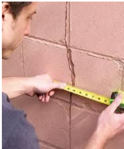
Ilustración 33. Falla o fisura mayor, inicio de grieta en muro. Fuente: www.construmatica.com
