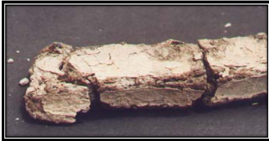
Ilustración 16. Patologías físicas por oxidación y humedad.
