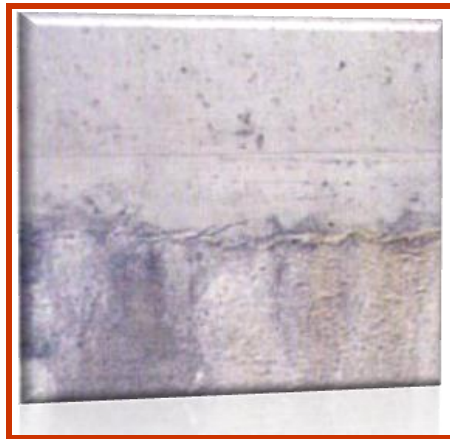
Ilustración 35. Falla o fisura en la junta horizontal Fuente: www.construmatica.com
