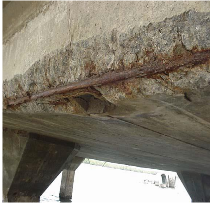
Ilustración 31. Falla por corrosión del acero del esfuerzo Fuente: www.construmatica.com
