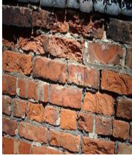
Ilustración 37. Falla por erosión física por rozamiento Fuente: www.construmatica.com
