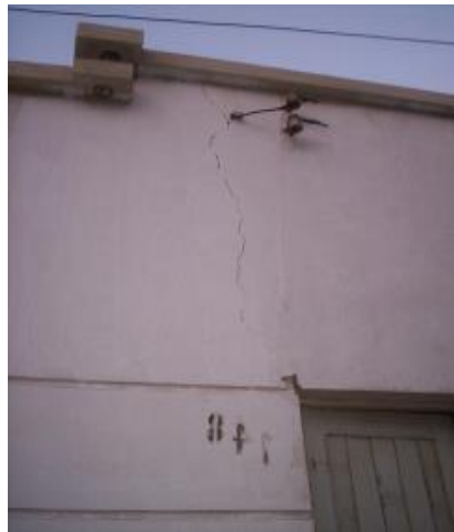
Ilustración 32. Falla o fisura iniciada en esquina de boquete Fuente: www.construmatica.com
