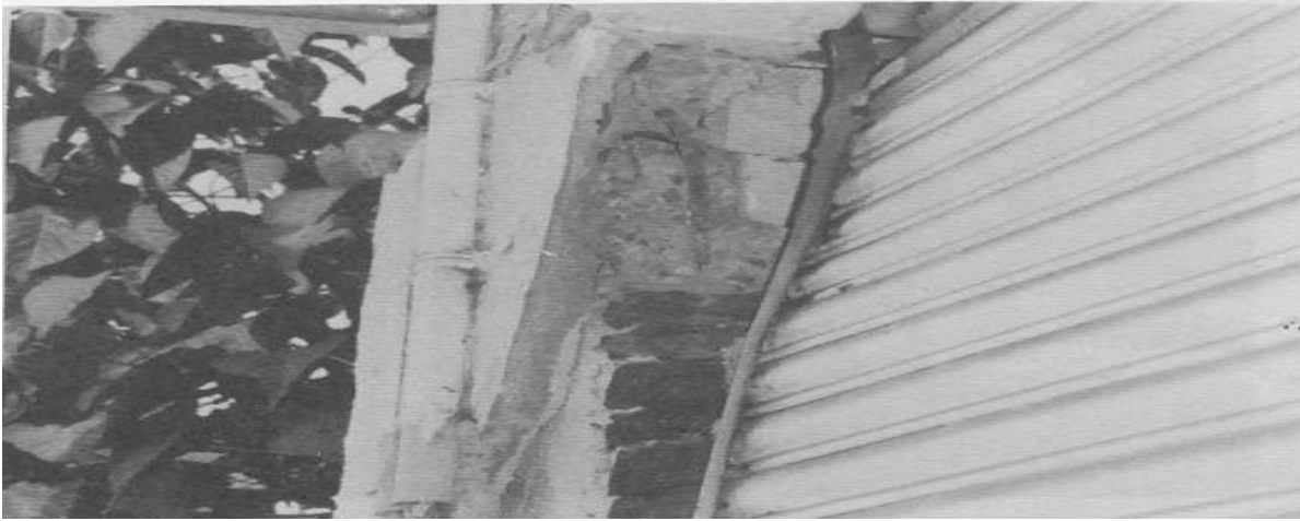
Ilustración 5. Agrietamiento inclinado y descacaramiento o fractura de concreto de la columna.
