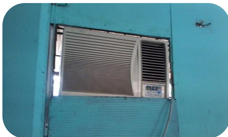
FIGURA 8 CLIMATIZACIÓN DEL LABORATORIO
