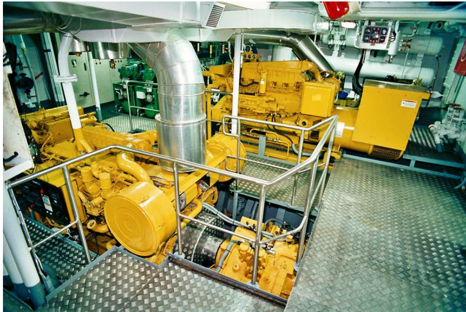
Figura 2.18 Departamento de máquinas del buque, Elaborado por: Paredes Torres Galo Dionicio
