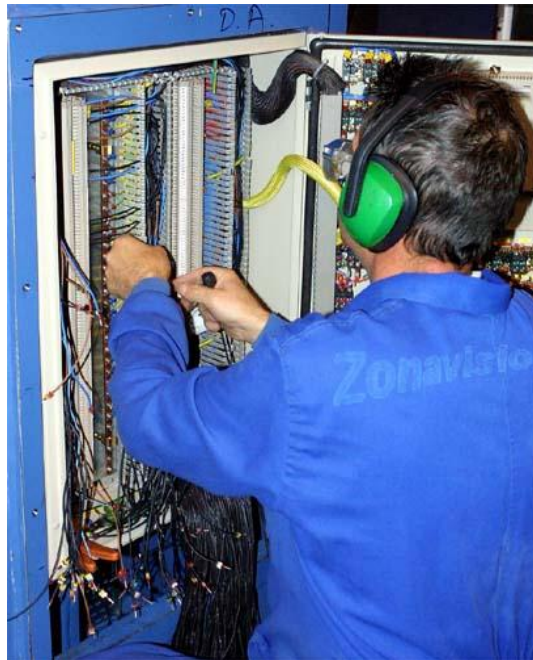
Figura 2.13 Riesgos eléctricos en tableros, Elaborado por: Paredes Torres Galo Dionicio
