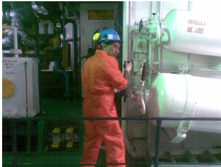
Figura 2.14 Riesgo en cilindros presurizados de aire, Elaborado por: Paredes Torres Galo Dionicio
