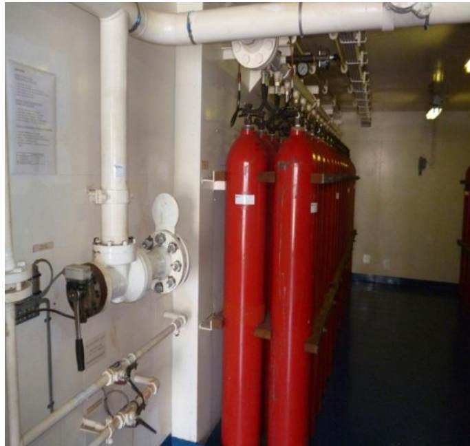
Figura 2.12 Banco de CO2 para control de incendios, Elaborado por: Paredes Torres Galo Dionicio
