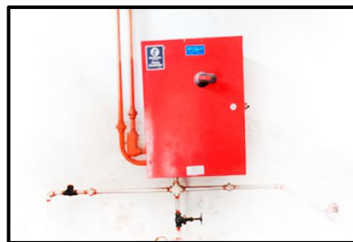
Ilustración 17 Tablero de control de la bomba JOCKEY
