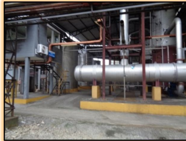
Ilustración 4 Área: Planta concentradora de vinaza
