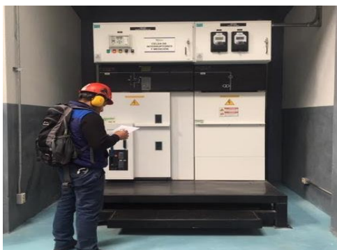
Figura 8: Identificación de Tableros Eléctricos (Fuente Autor)
