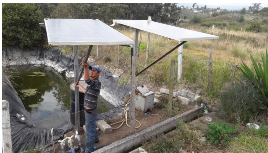
Figura 39-3: Armado de mástil y paneles solares
