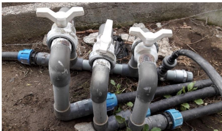
Figura 41-3: Instalaciones manuales de las llaves de agua
