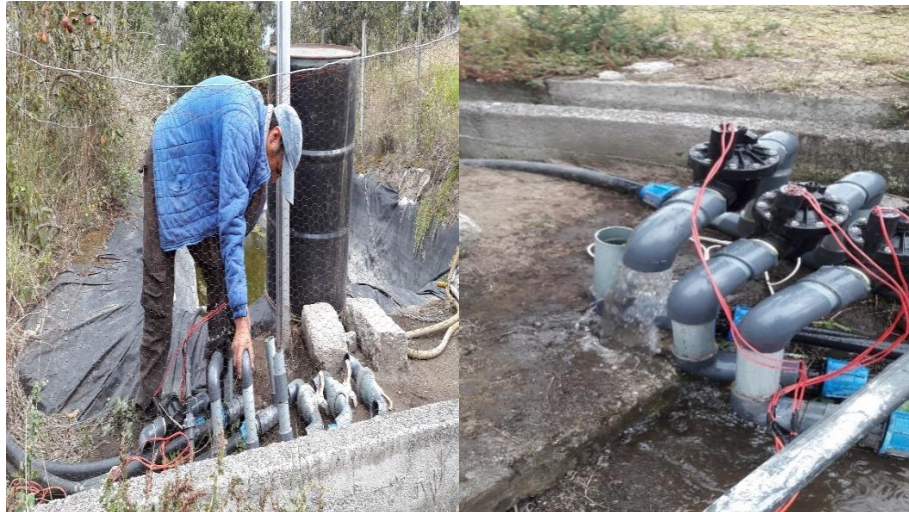
Figura 43-3: Reemplazo de electroválvulas por las llaves manuales
