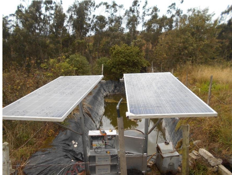
Figura 40-3: Paneles solares a 11^{\circ} grados
