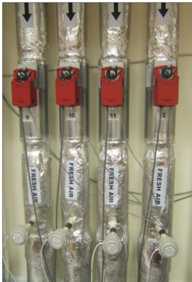
a. PV supply air pipe
