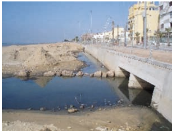
Figura 2. Vertido de aguas residuales en la costa.
