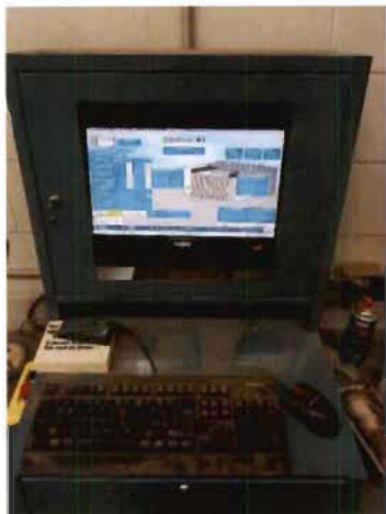
Figure 50 Station de contrôle numérique du séchoir
