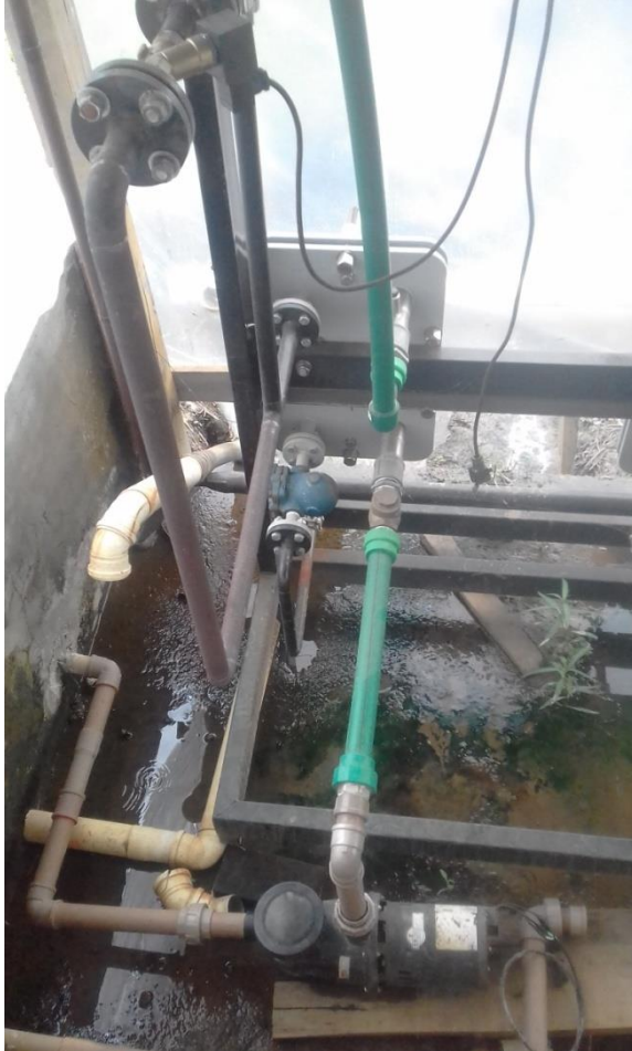
Figura 6 – Vista Parcial do Sistema de Aquecimento da Água do Laboratório de Larvicultura
