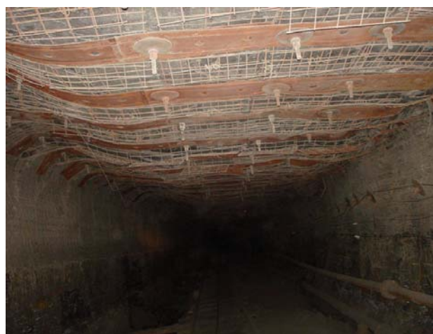
Рисунок 4. Состояние кровли 163-го сборного штрека шахты “Степная”
